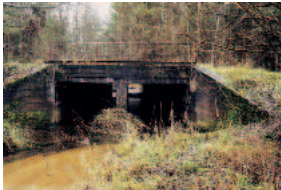
Bestand des Durchlassbauwerkes vor der Planung und Realisierung des Renaturierungsprojektes (Foto: BIW Erfurt; 1999)
